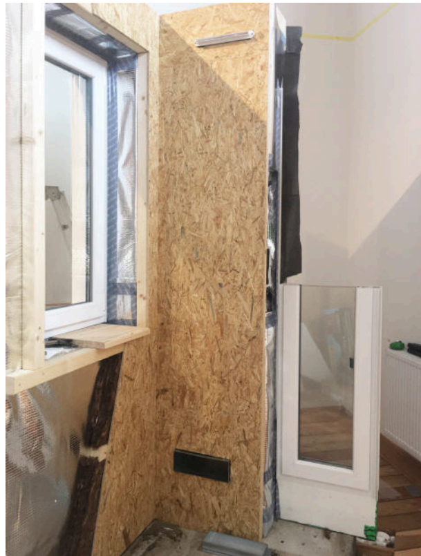
Unten ist die Zugriffsöffnung für die Entnahme des Filters zu erkennen
